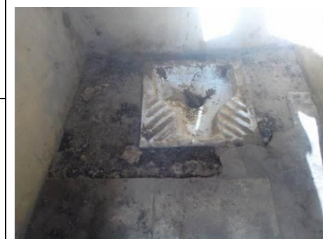
Toilette du lycée mal entretenue
