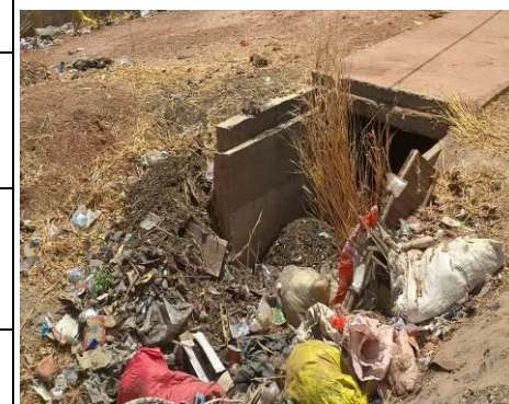
Des déchets solides à l'exutoire d'un caniveau d'évacuation d'eau pluviale le long de la RN7
